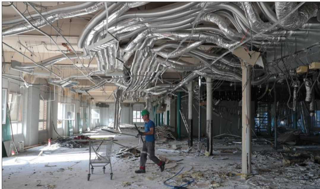
Au premier étage du bâtiment 23, mardi matin. Cloisons et faux plafonds ont déjà été enlevés par l'équipe de Batichoc. Reste à enlever tout un dédale de conduits et de câbles : les anciens locaux de Wärtsilä étaient riches en réseaux divers (chauffage, aération et climatisation, électricité...) ! Photo L'Alsace
